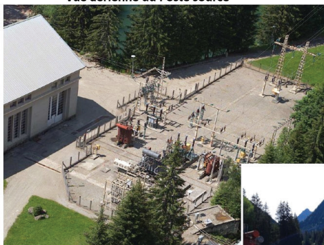
Vue aérienne du Poste source
